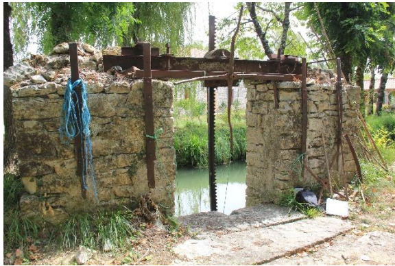
Vannage de décharge
