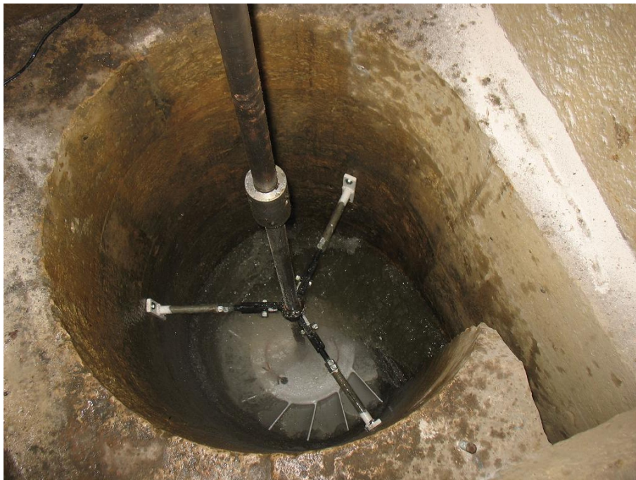
Figure 20 Rouet et cuve du Moulin de Batan, puissance électrique d'environ 3 kW
