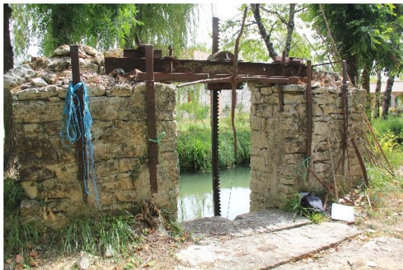
Vannage de décharge
